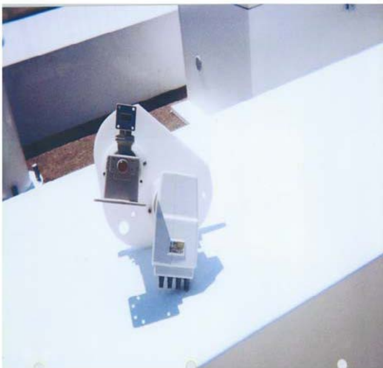
Torreta feed Asamblea para arreglos de antena para aplicaciones de multifrecuencia
